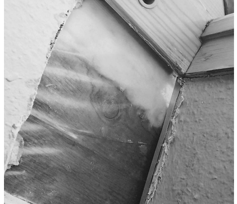
Abb. 4.181: Ungenügender Zwischenraum zwischen benachbartem Sparren und der Gipskarton-Leibungsverkleidung; der erforderliche Dämmstoff fehlt hier völlig.
