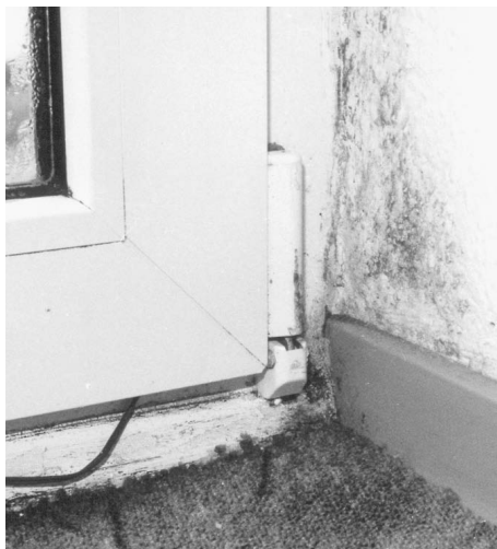
Abb. 4.13: Schimmelpilzrasen am unteren Ende der Fensterleibung
