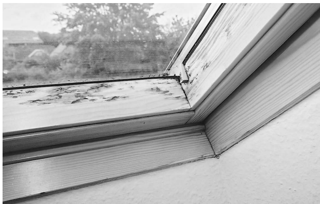
Abb. 4.182: Ablösung der Lasurbeschichtung ein Jahr nach der Überholung; Schimmelpilzsaum entlang des unteren Scheibenrandes infolge Überbeanspruchung durch Scheibenkondensat
