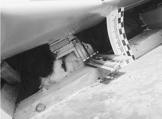
Abb. 4.180: Die Holzfensterzarge liegt 40 mm oberhalb der Dämmstoffebene; im Eckbereich liegt die Gipskarton-Leibungsverkleidung gegenüber dem Außenklima ungeschützt frei.
