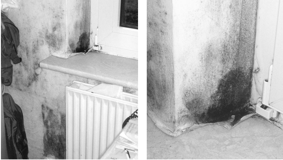
Abb. 4.10 und 4.11: Dominante Schimmelpilzrasenbildung im unteren Leibungsdreieck und neben dem Heizkörper sind Indiz für einen Tauwasserausfall aufgrund zu geringer Beheizung.
